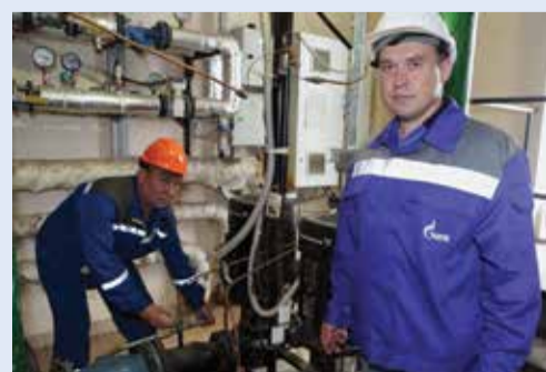
Бригада, обслуживающая тепловые пункты в институте Склифосовского, работает в круглосуточном режиме. На фото: мастер участка Евгений Бетин и слесарь 5 разряда Василий Остроухов
