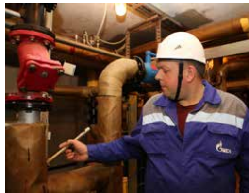
Мастер Олег Бондарев: проверяя работу оборудования в тепловом пункте общежития МИФИ, даже чувствует свою причастность к будущему мировой науки
