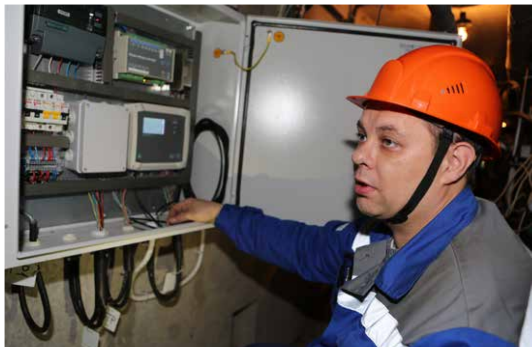
Шкаф автоматики, установленный в подвале жилого дома. На фото — слесарь КИПиА 5 разряда Филипп Кожома
