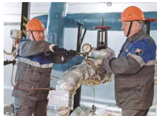
Ревизия запорной арматуры; на фото Игорь Горшков и Дмитрий Петров
